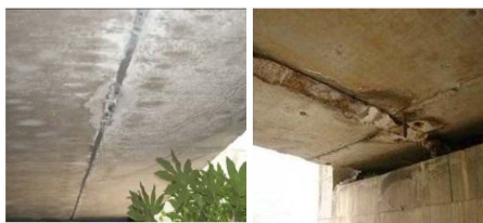
图1 空心梁板桥梁出现裂缝损害
