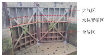
图 1 船闸、闸门腐蚀情况
