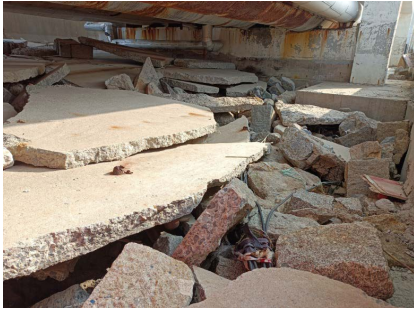
图 1 防波堤面层碎裂
