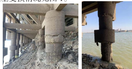
图 1 桩基破损情况
