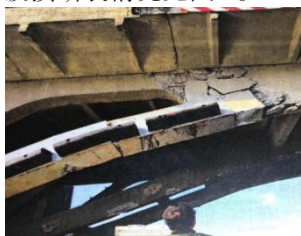
图3 船舶撞击致拱腿破损断裂图
