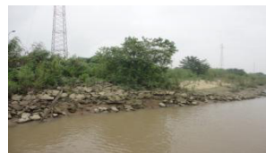
图 2 下游护坡损坏
