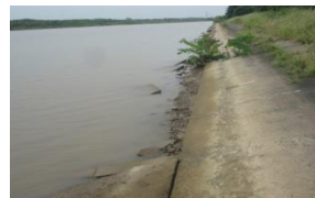
图 3 上游护坡损坏
