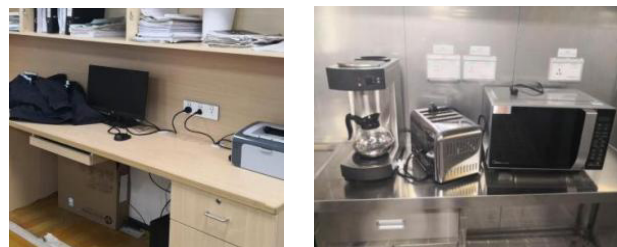
图 2 船员办公室、厨房等生活区插座现状
