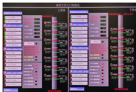
图 1 “初始化”闸门调整界面图
