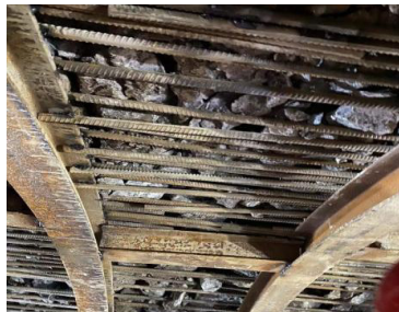
图 1 隧洞拱顶塌方破碎围岩
