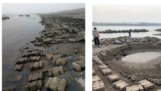
图7 江口水道柳条洲右缘护岸排体未抛石压载区
