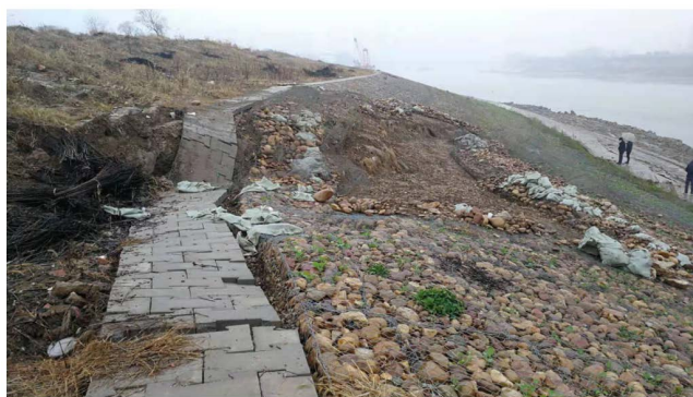
图4 坍塌区实景图
