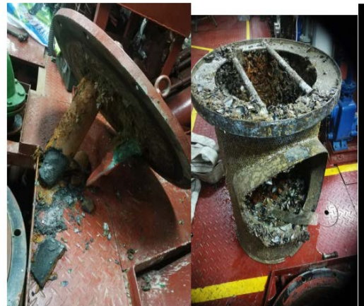
图2 海底门电极消耗严重，但滤器上海生物生长依然过多
