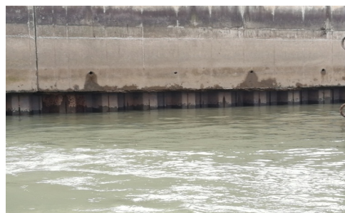
图 3 伸缩缝处钢板桩接缝漏水
