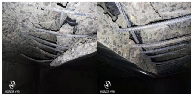
图 2 预应力束拉崩现场照片
