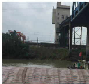
图3 护岸墙身倒塌
