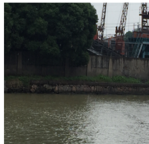
图2 护岸墙身倒塌
