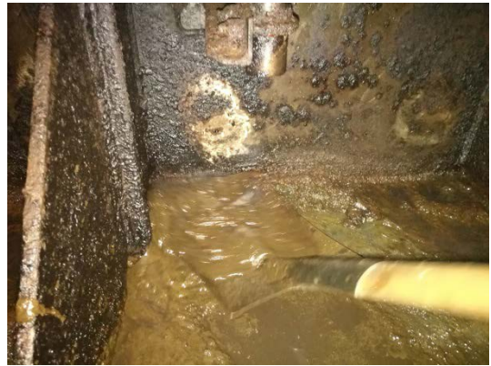
图3 燃油日用/沉淀柜中沉积物
